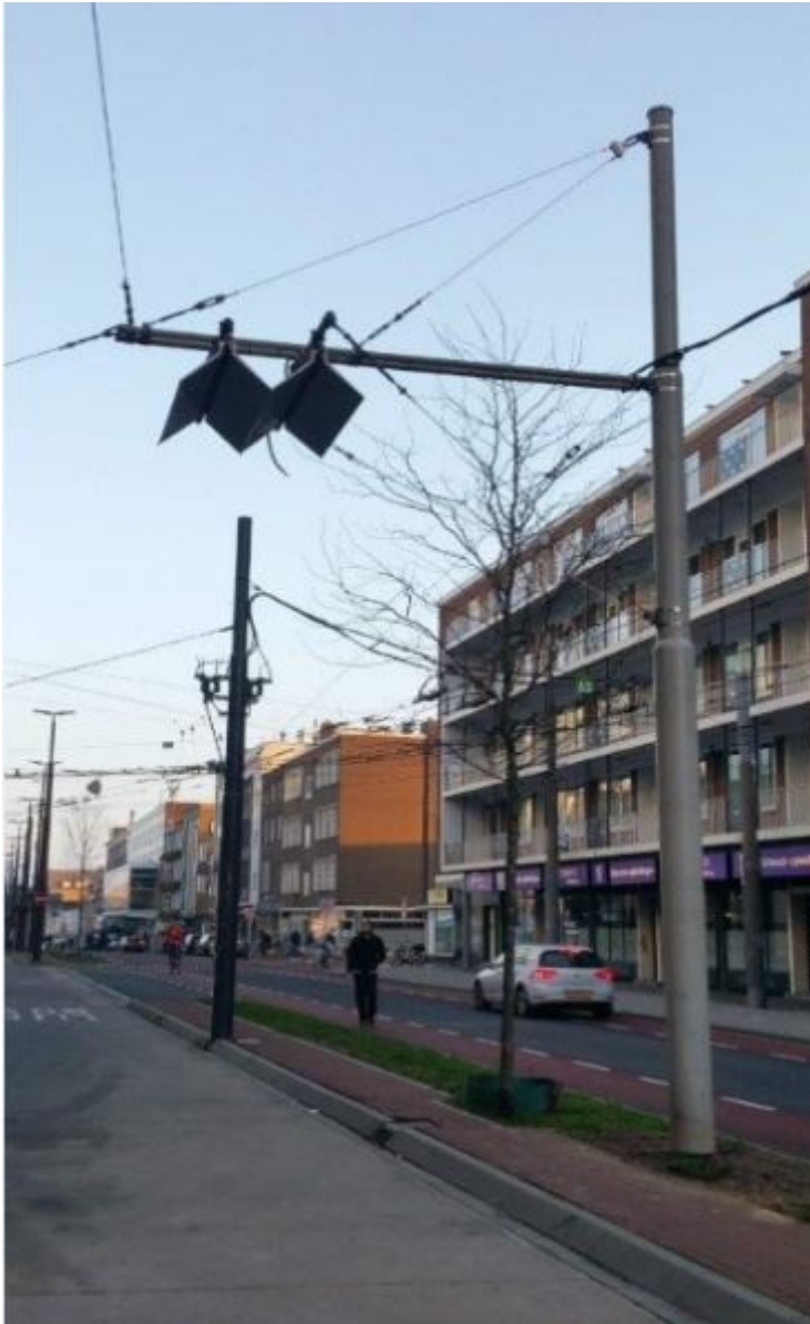
Afbeelding: detailfoto opportunity charging point
